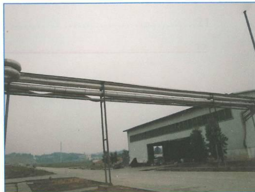
工艺尾气回收管道
